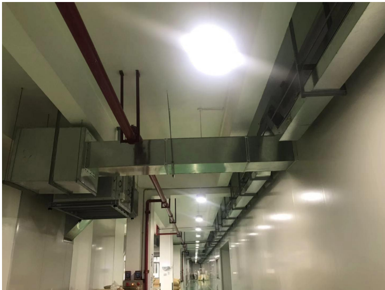
进入非清洁区的空气经过中效过滤
